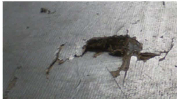
🔧 Pavimentazione: Deformazioni o perforazioni dalla riparazione economicamente conveniente
