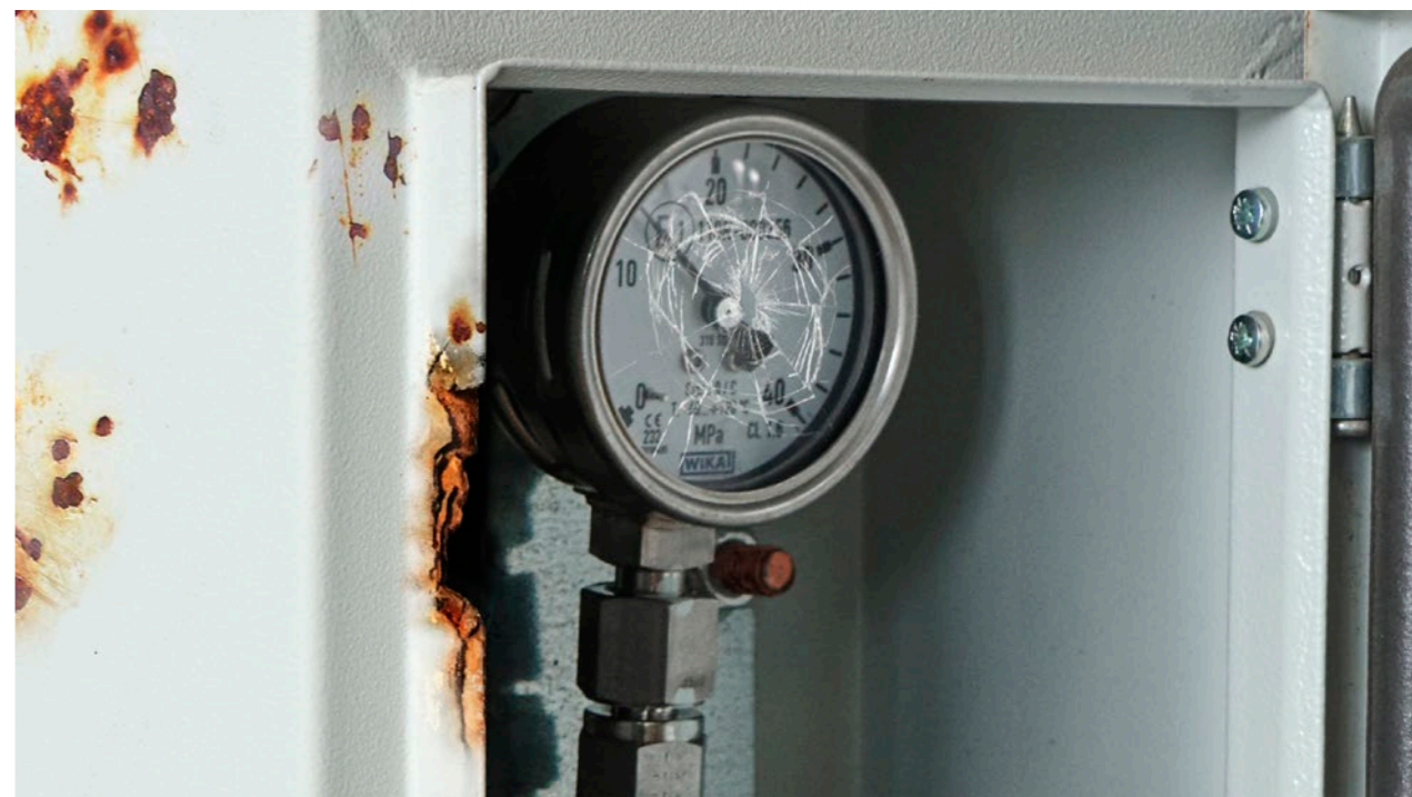
Assenza della chiave della scatola protettiva, danni al bocchettone per il rifornimento di CNG o al manometro → importo relativo alla sostituzione dell'intera scatola.
